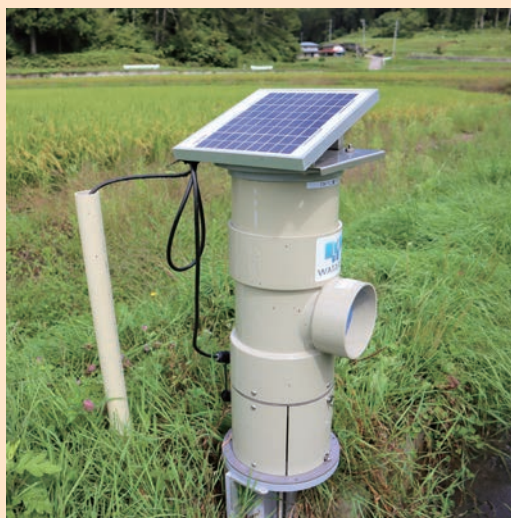
設置された自動給水栓
