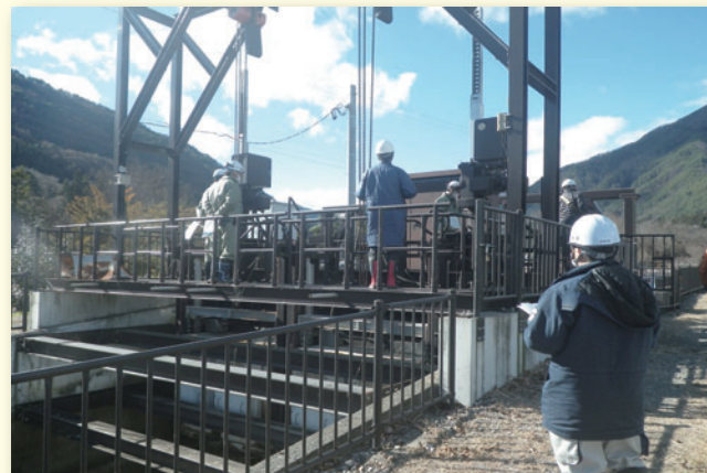
波田小水力発電所
