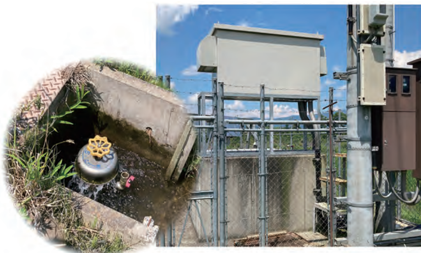
ほ場に設置された自動給水栓(左)と揚水機場(右)
