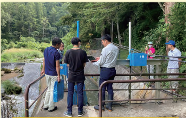
▲ 水門の自動化・小水力発電 (飯綱町芋川)
